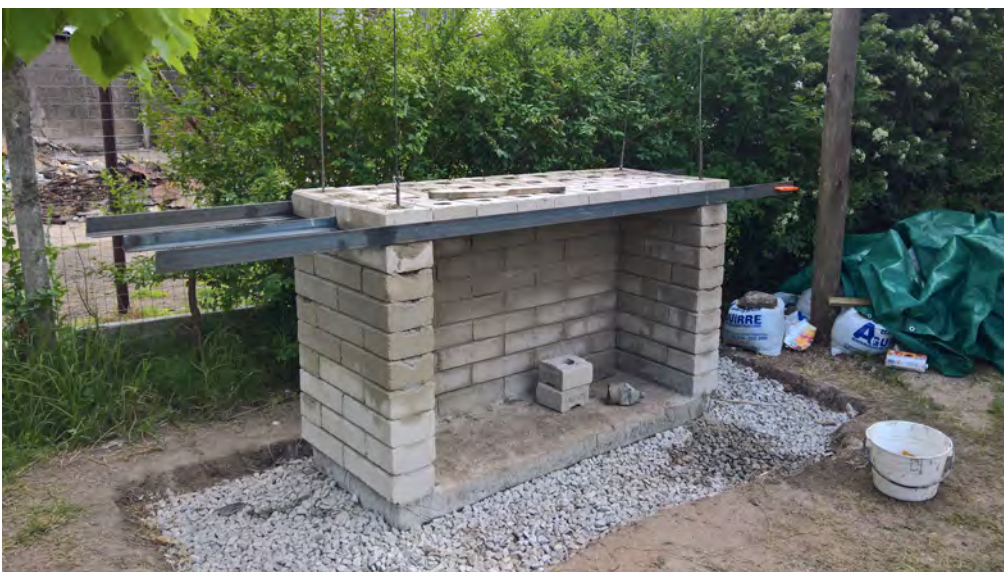
Figure 124 : La table est construite avec les briques posées sur les profils métalliques
