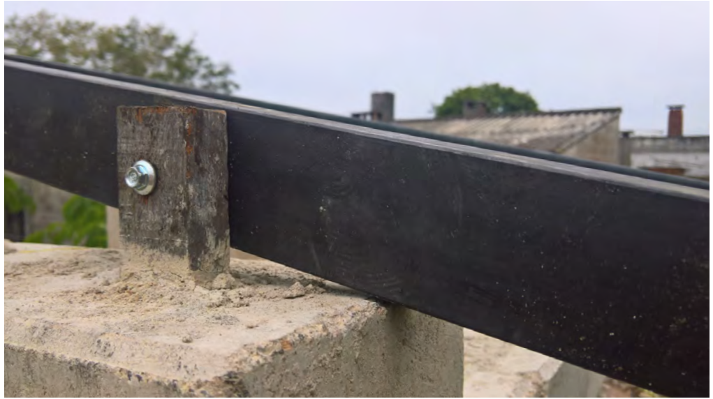
Figure 131 : Charpente métallique fixée à l'aide d'un bois dur scellé dans le mur
