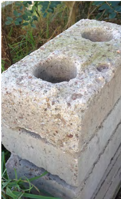
Figure 138 : Bloc exposé 8 mois aux intempéries.
