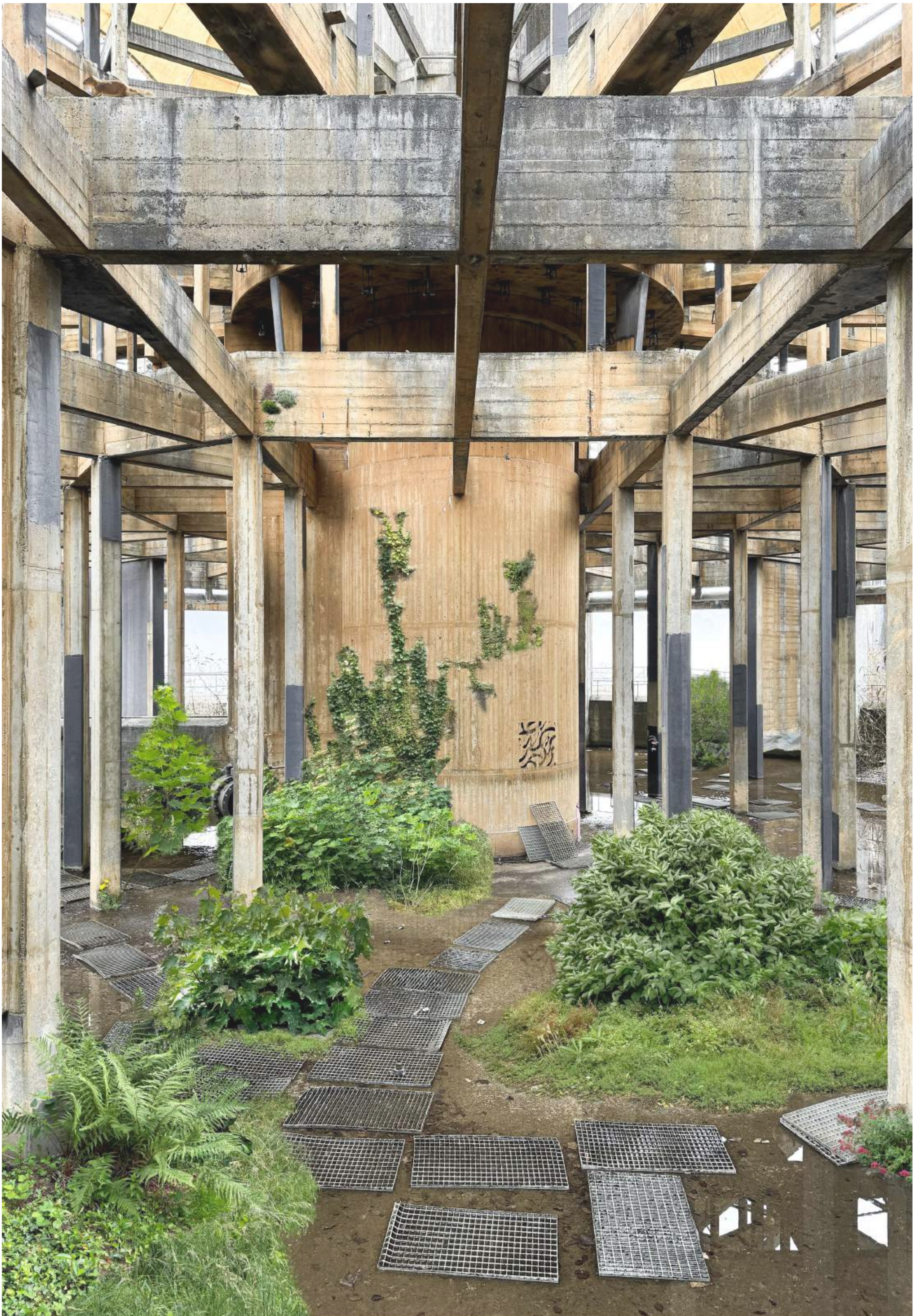
TOUR DE REFROIDISSEMENT
